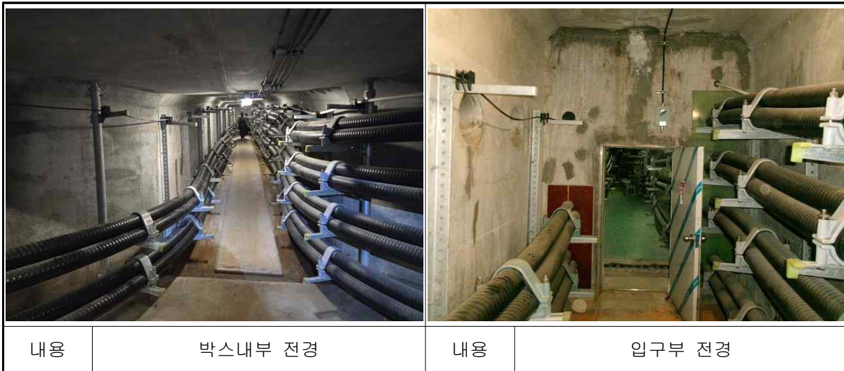
【사진 3.1】 문발SS인출 전력구 현황
